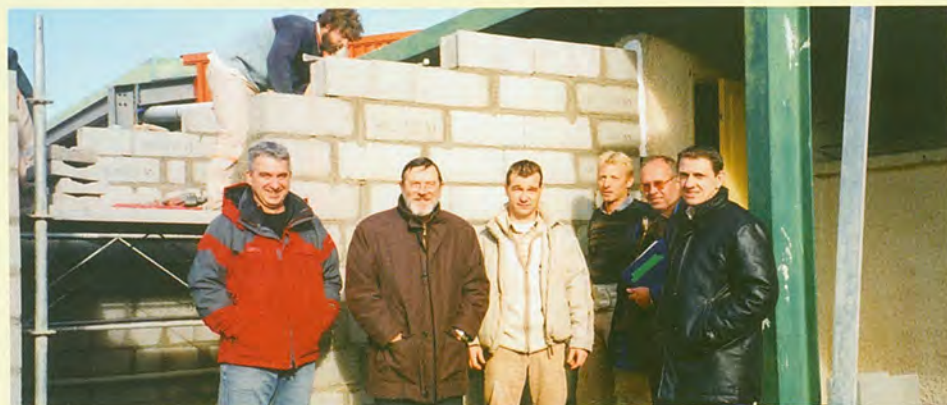
La visite du chantier de la salle polyvalente par José LORENZO et les responsables des travaux
